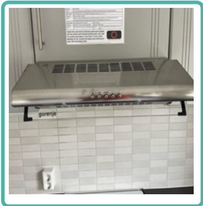
Kjøkkenvifte blokk A/B/C
